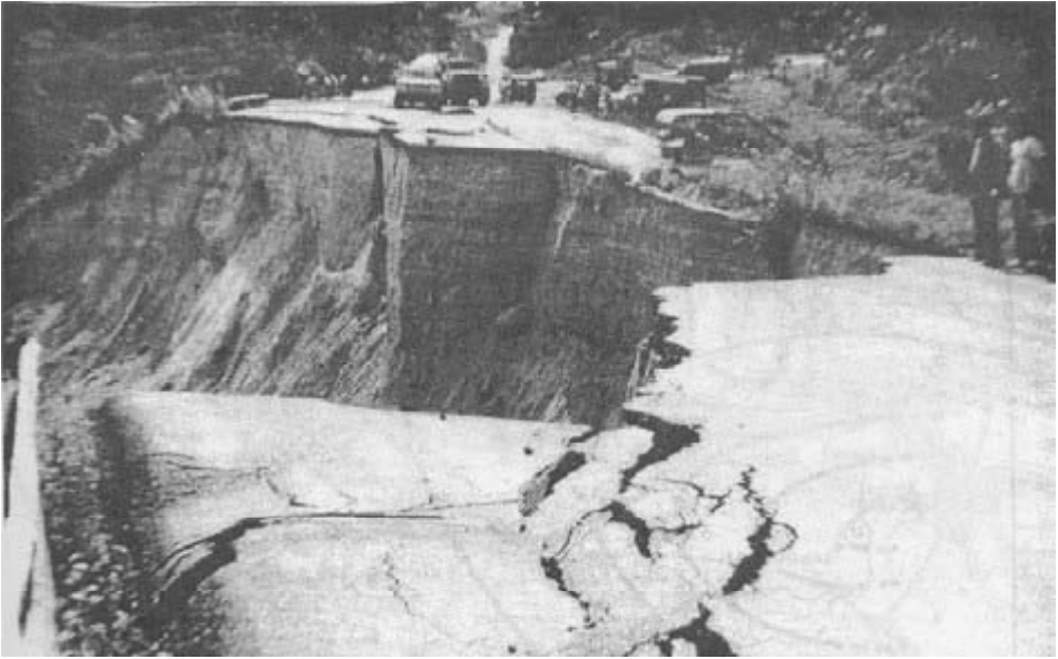
Figura 6 Terraplén deslizado en la localidad de San Josesito, estado Táchira. Tomado de Singer et al. (1982)
