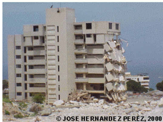
Fig. 11. Tomada del Lexico (2001), donde se aprecia el daño a uno de los edificios.
