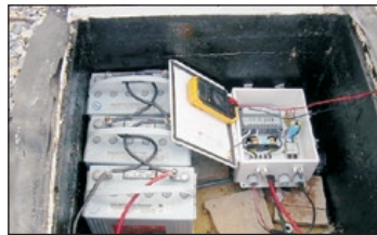
Fig.38. Tanquilla de alimentación de una estación remota.
