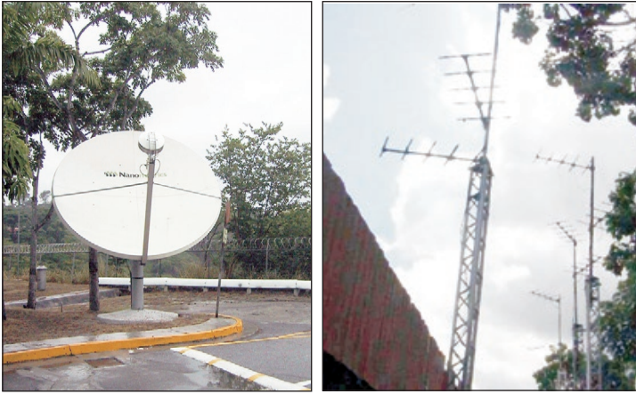
Figs. 34 y 35. A la izquierda la antena satelital de recepción en la sede central de El Llanito. A la derecha el patio de antenas de transmisión telemétrica de FUNVISIS.
